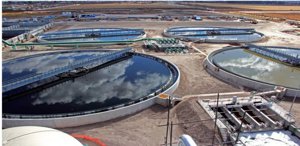
Figura 22. Planta de Tratamiento de Aguas Residuales (PTAR) El Ahogado.
